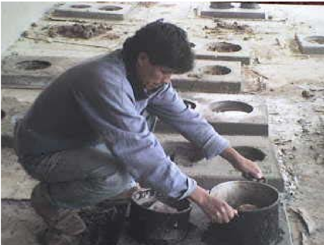
TECNICO PROCEDE AL RETIRO DE LAS CACEROLAS QUE SIRVIERON DE MOLDE PARA OBTENER LAS PLATAFORMAS A INSTALARSE EN LAS VIVIENDAS DE LOS BENEFICIARIOS
